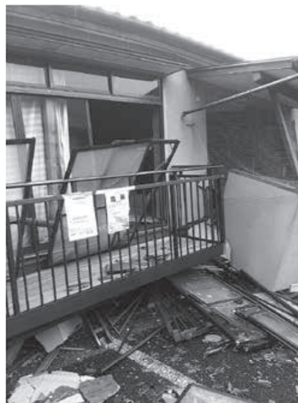
▲1階部分が潰れた被災地の家屋
