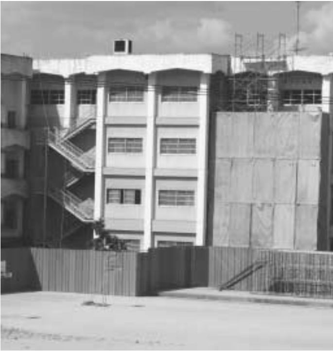
耐震補強工事が実施されている第二大山崎小学校管理棟
