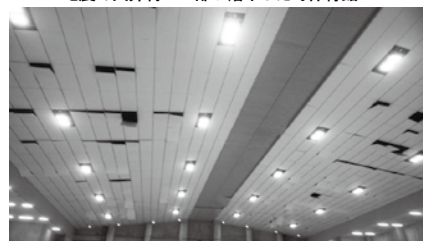
地震で天井材の一部が落下した町体育館
