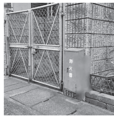
地域、町内会での共用消火器設置例
