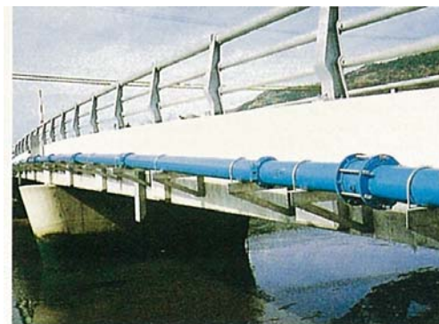
水道管橋梁添架
