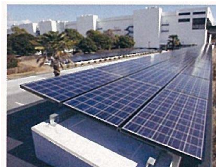
太陽光発電システム
